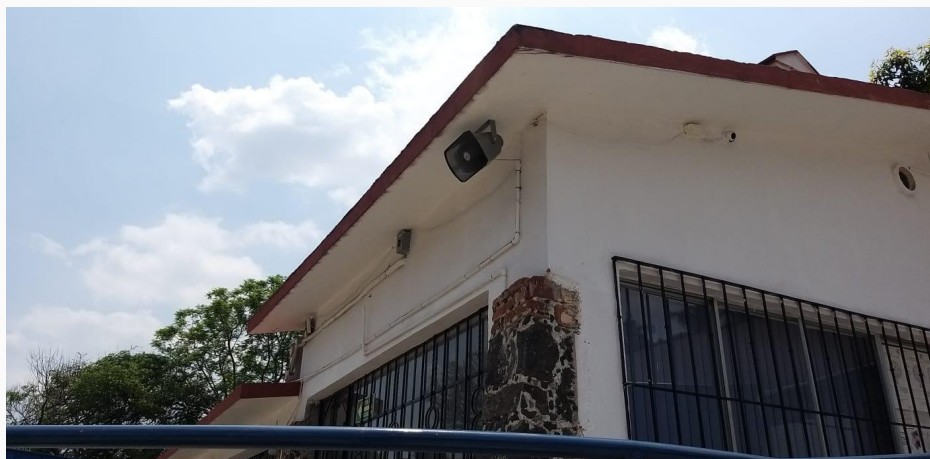
Figura 20 :Altavoces instalados para el sistema de alarma
